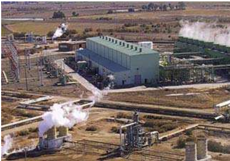
Figura 9. Geotermoeléctrica en Cerro Prieto, Mexicali, Baja California, México
