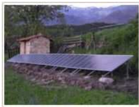
Figura 2. Instalación fotovoltaica aislada
