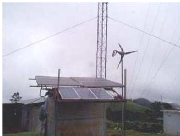
Figura 34. Instalación mixta fotovoltaica-eólica en Guatemala
