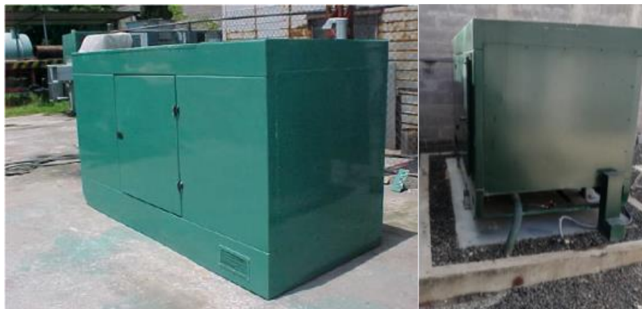
Figura 4. Grupo electrógeno estacionario
