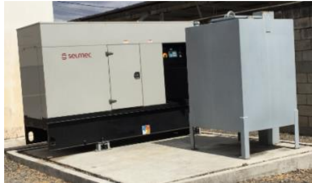
Figura 6. Grupo electrógeno con su tanque mensual y tanque diario
