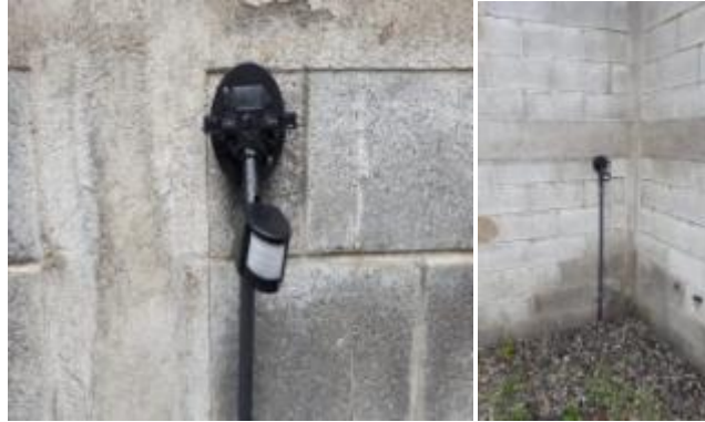
Figura 21. Instalación de sensores de movimiento y proximidad
