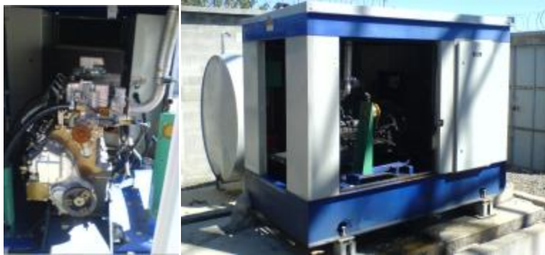
Figura 25. Daño causado al grupo electrógeno
