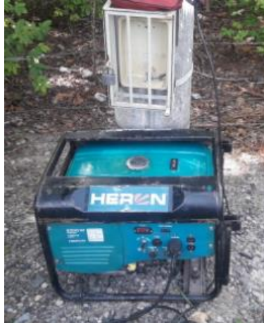
Figura 5. Imagen de un generador eléctrico
