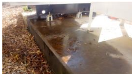
Figura 26. Derrame de diésel por robo
