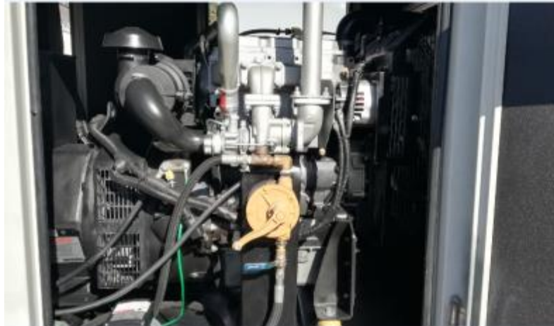
Figura 8. Grupo electrógeno enfriado por agua, motor marca Perkins
