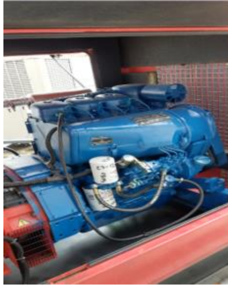
Figura 7. Grupo electrógeno enfriado por aire, marca Deutz
