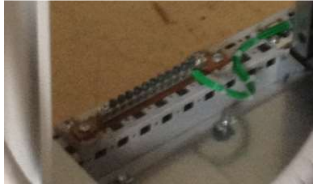
Figura 124. Detalle de barra de tierra en panel
