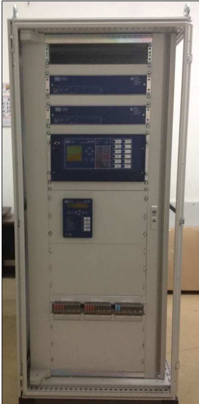
Figura 130. Equipos de protección y control en bastidor
