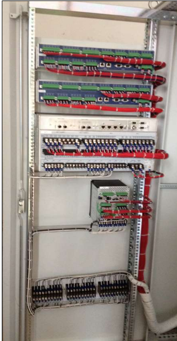
Figura 131. Cableado de equipos de control y protección
