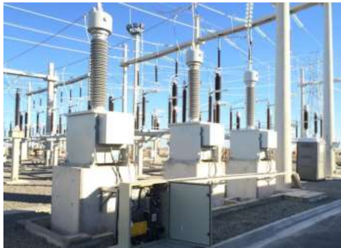
Figura 15. Transformador de tensión
