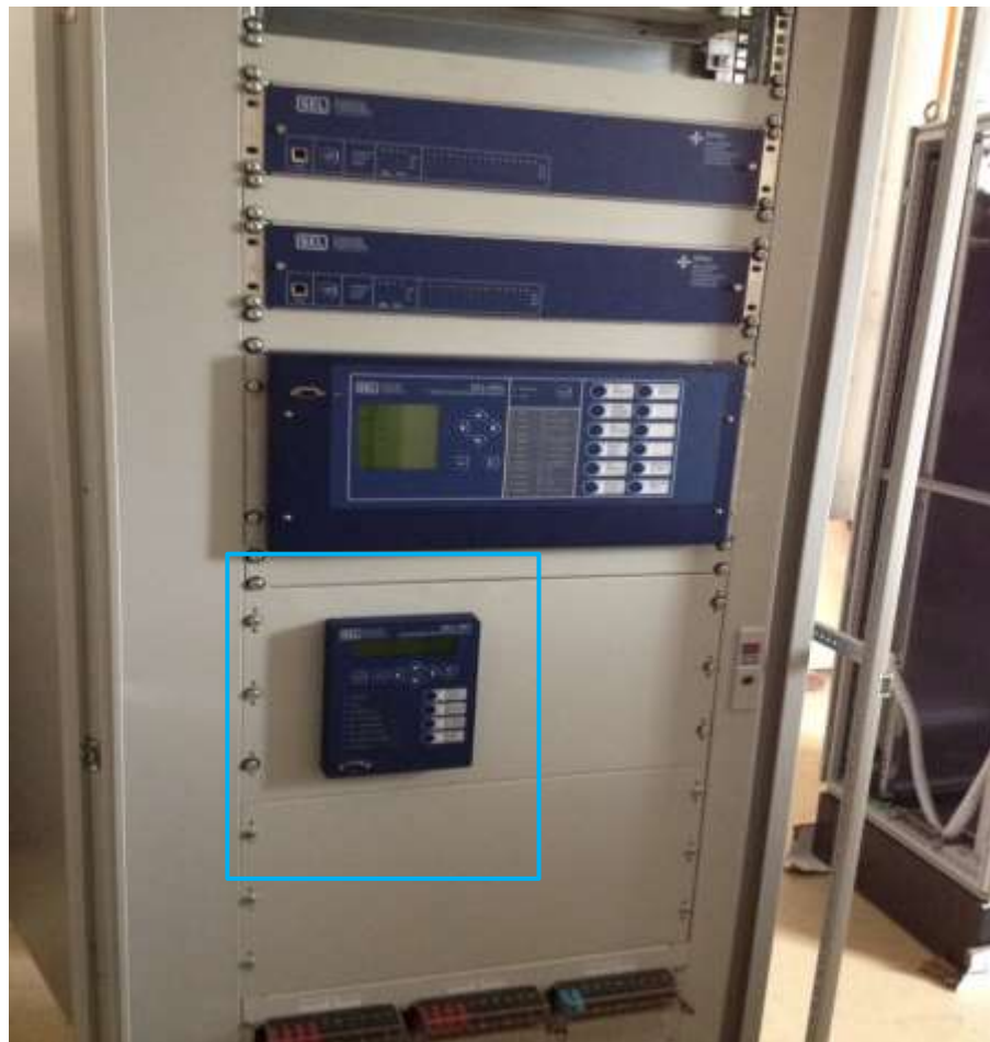
Figura 119. Detalle frontal de montaje de equipos en bastidor abatible
