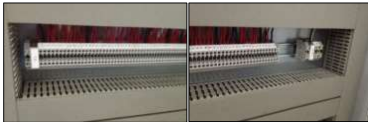
Figura 136. Detalle de tablilla de terminales #3
