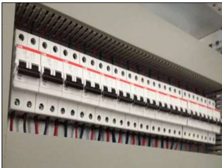
Figura 129. Detalle de interruptores automáticos termomagnéticos
