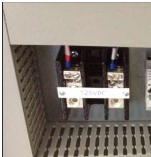
Figura 145. Detalle de tablilla de terminales alimentación 125VDC
