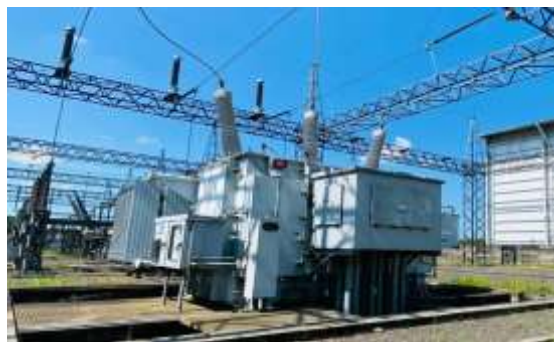
Figura 47. Transformador de potencia de la subestación
