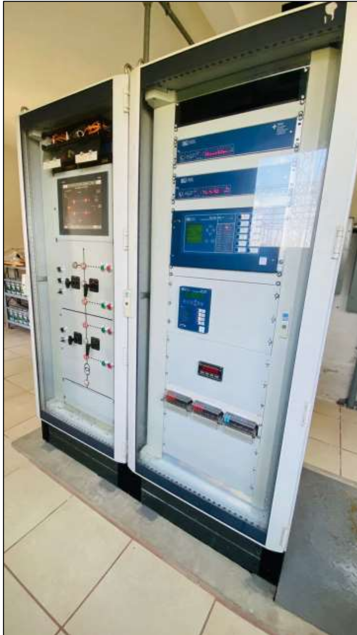
Figura 179. Paneles de control, protección y medición energizados
