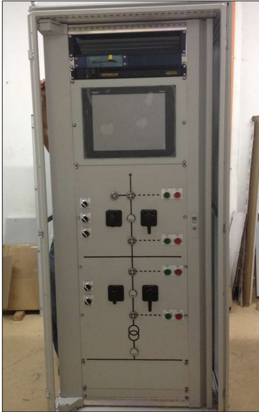
Figura 139. Equipos de control local y mímico
