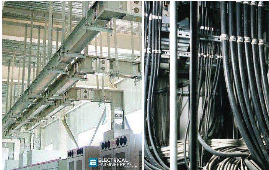
Figura 21. Sistema ducto barra y cables como alimentador del tablero principal
