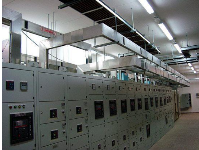
Figura 22. Panel de distribución de potencia con ducto barra
