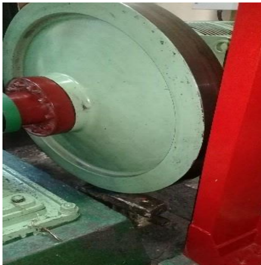
Figura 28. Volante de inercia turbina Francis
