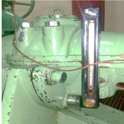
Figura 36. Nivel de aceite, chumaceras de la turbina
