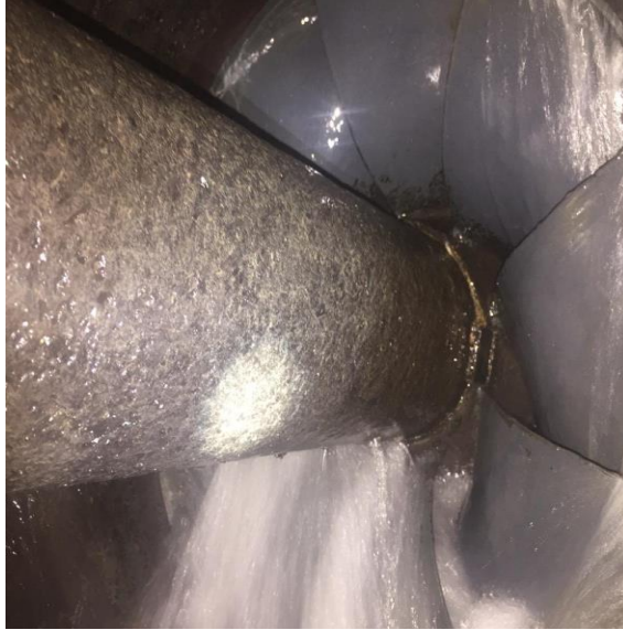
Figura 24. Prueba distribuidor turbina Francis
