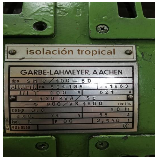
Figura 30. Placa del generador de la hidroeléctrica
