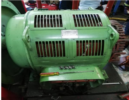
Figura 31. Generador, hidroeléctrica Chichaic
