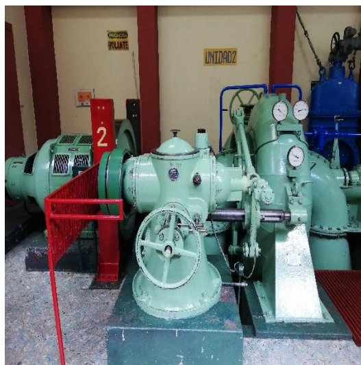
Figura 27. Regulador de velocidades turbina Francis
