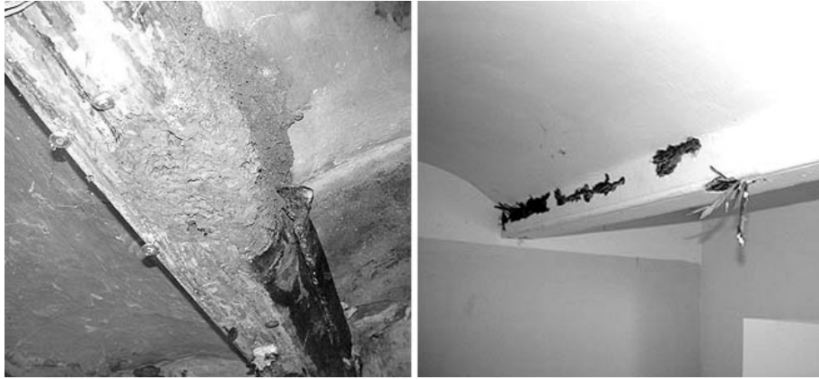
Figura 12. Daños en madera estructural
