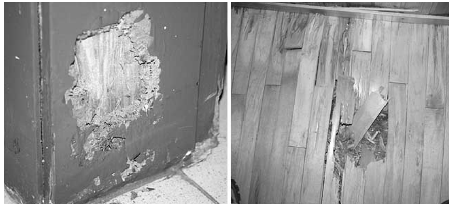
Figura 11. Daños en madera funcional
