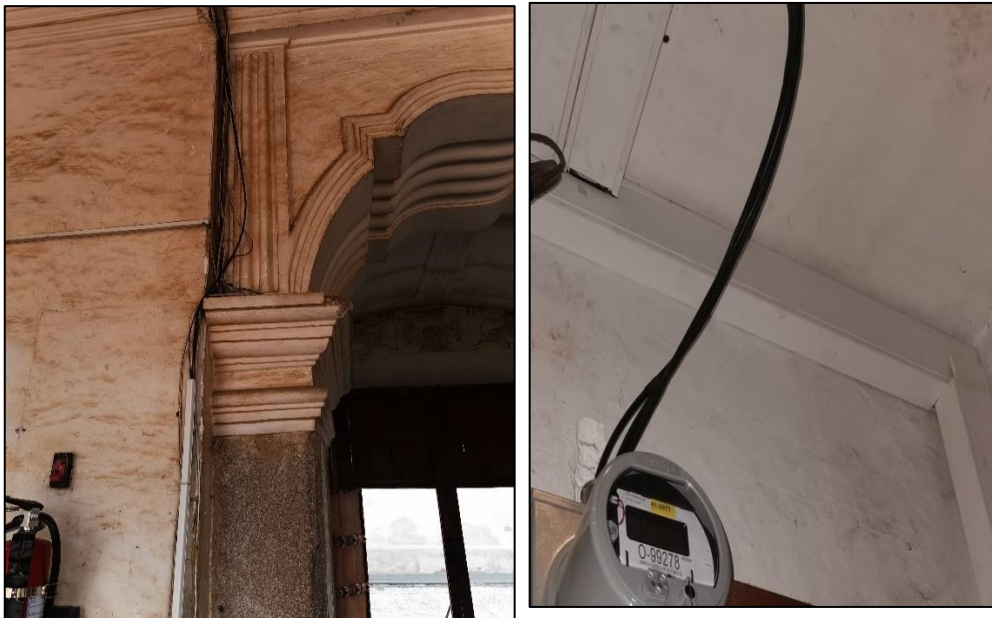
Figura 22. Conductores no canalizados en el Museo de Arte Colonial
