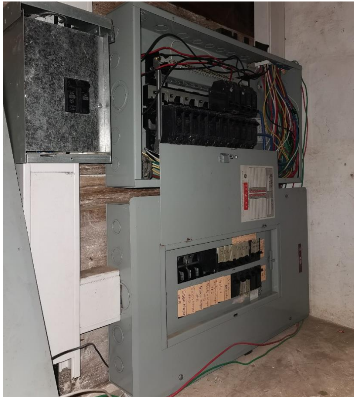
Figura 47. Condiciones actuales de tableros de distribución
