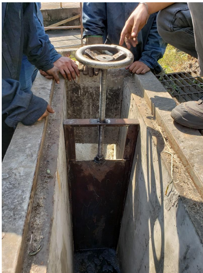
Figura 11. Compuerta instalada en canal
