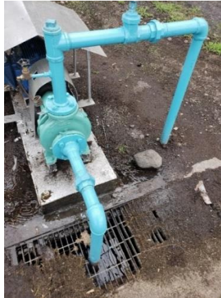
Figura 17. Línea succión y descarga de bomba
