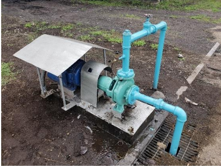
Figura 18. Motor-bomba acondicionador de ceniza
