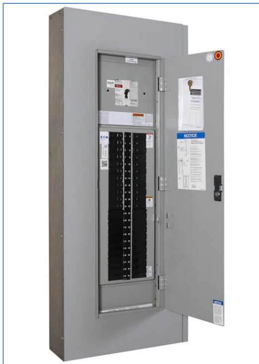
Figura 14. Tablero principal de distribución
