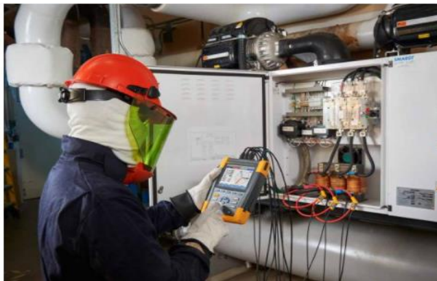
Figura 38. Medidor de Calidad de Energía Fluke 435 II
