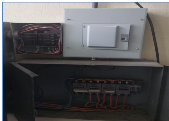
Figura 8. Tablero principal y secundario
