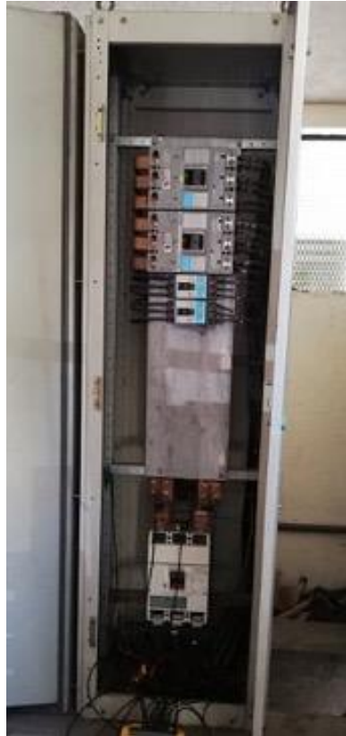
Figura 57. Interruptores ramales, celda 3
