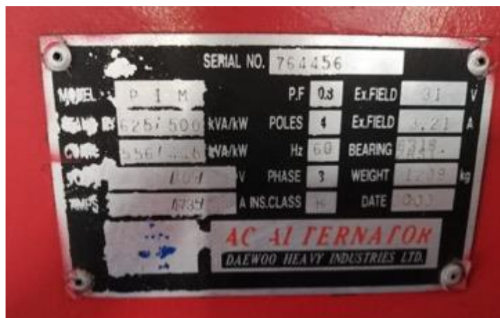
Figura 53. Placa de características de planta de emergencia
