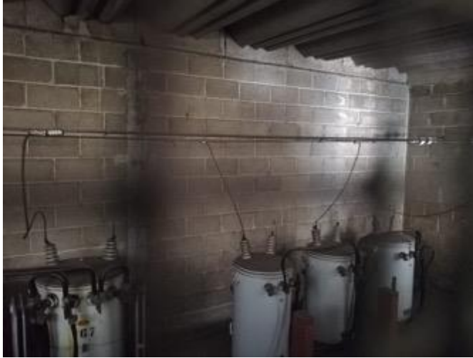
Figura 49. Banco de transformadores 2
