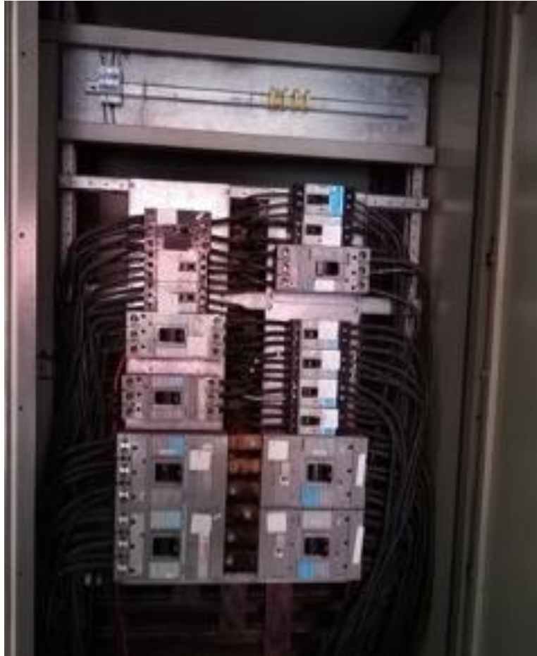
Figura 56. Interruptores ramales, celda 2
