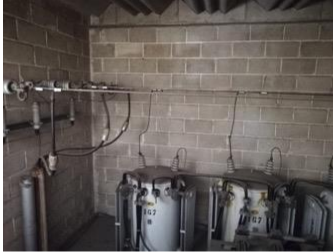
Figura 48. Banco de transformadores
