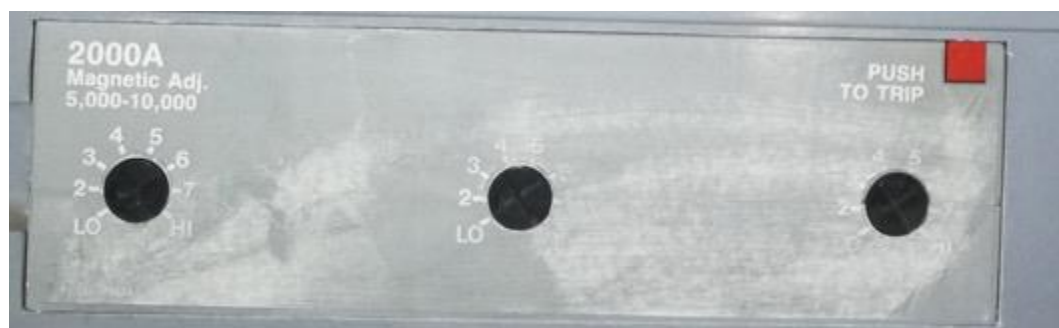
Figura 62. Termomagnético ajustable del interruptor principal
