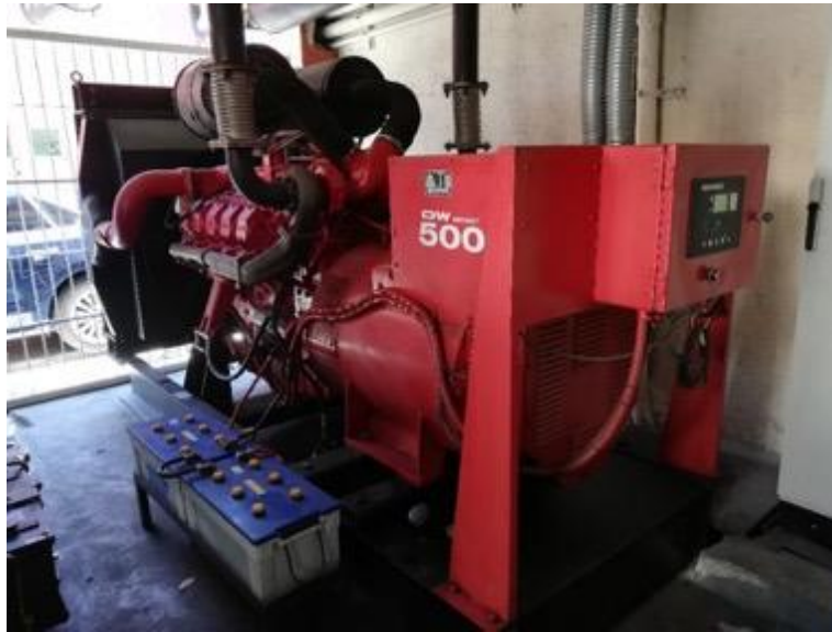
Figura 51. Planta de emergencia Daewoo
