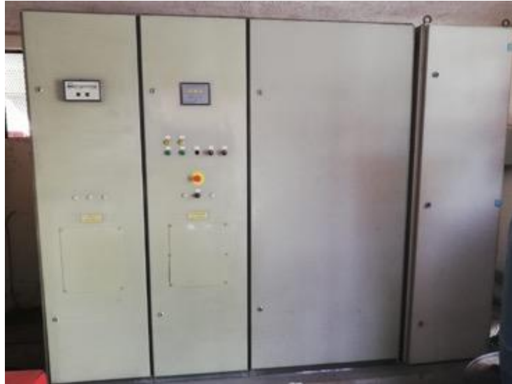
Figura 50. Celda con interruptor principal
