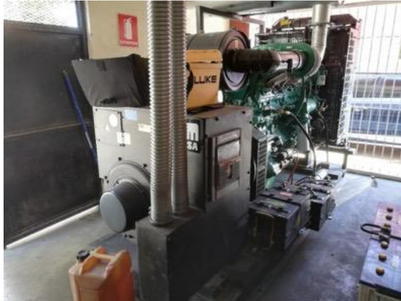
Figura 52. Planta de emergencia Stamford
