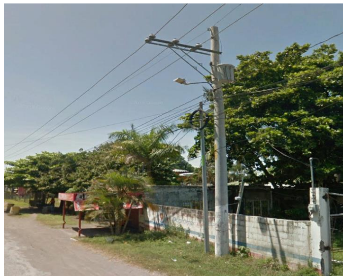
Figura 33. Estructura de media tensión
