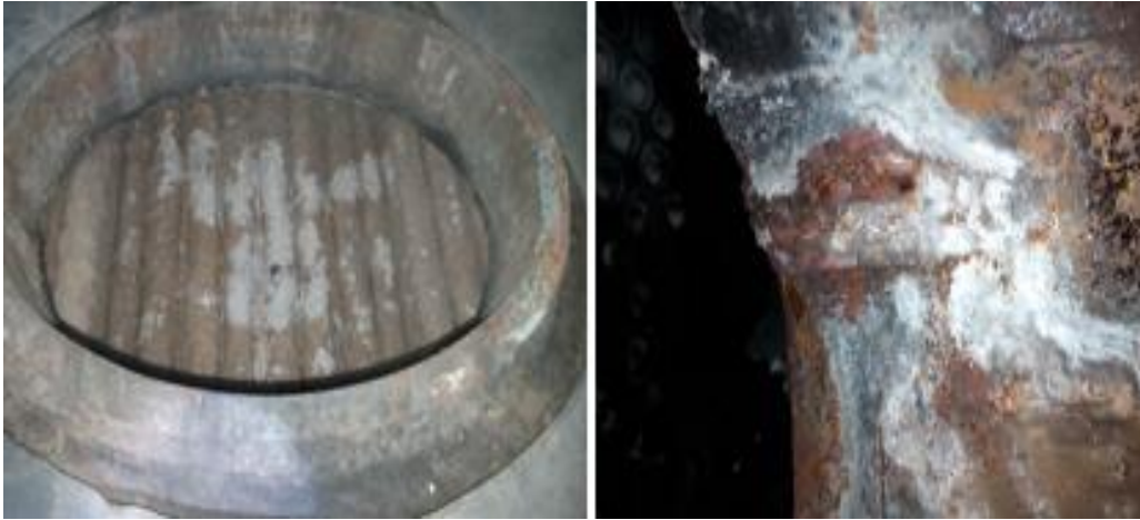
Figura 26. Caldera Kewanee boiler
