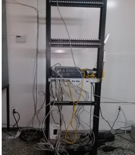
Figura 2. Rack principal cuarto servidores
