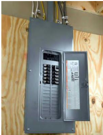
Figura 49. Tablero de distribución residencial
