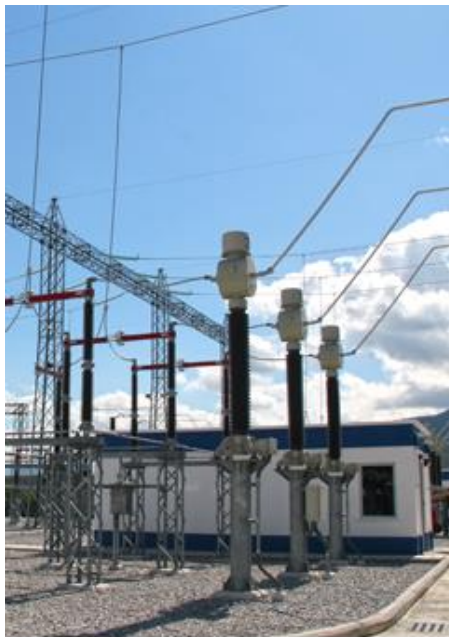
Figura 13. Trasformador de corriente
