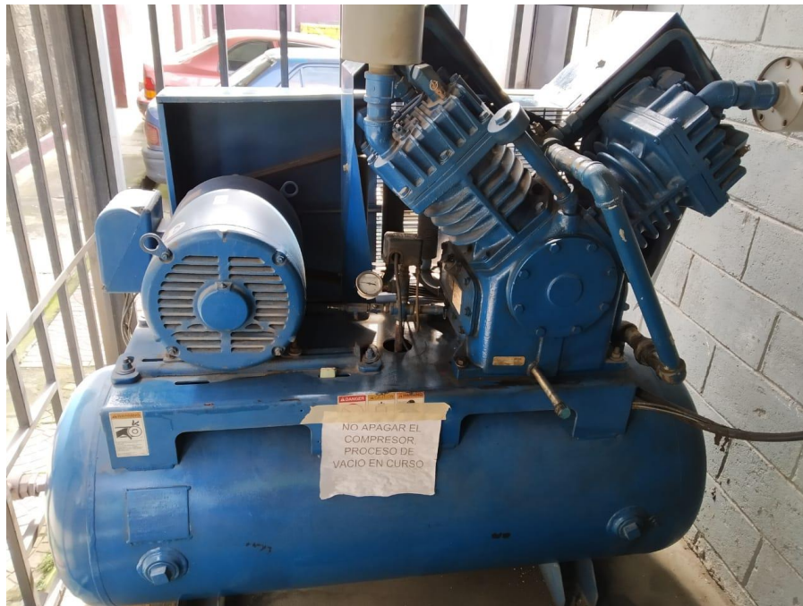
Figura 1. Compresor del hangar Aviateca
