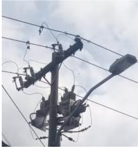
Figura 2. Acometida en media tensión con medición en poste
