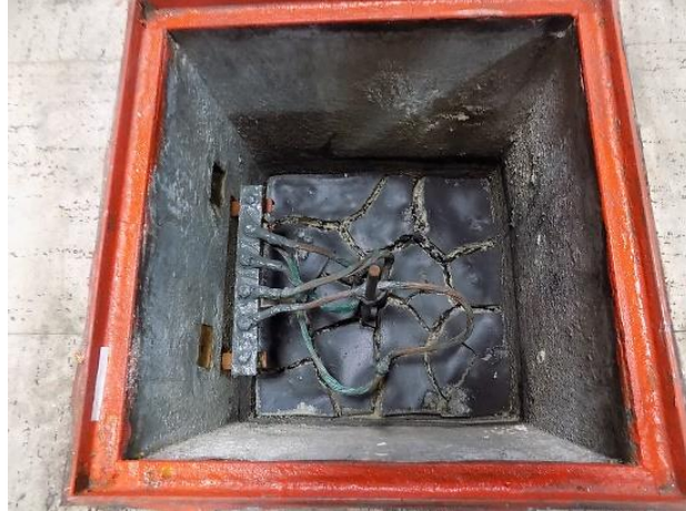
Figura 95. Caja de registro y mantenimiento
