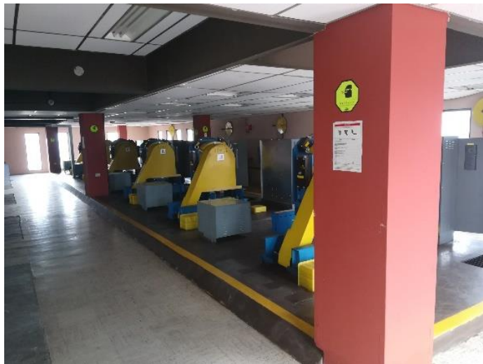
Figura 99. Cuarto de máquinas de ascensores en azotea edificio La Torre, en buenas condiciones de operación
