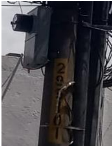
Figura 3. Equipo de medición en media tensión
