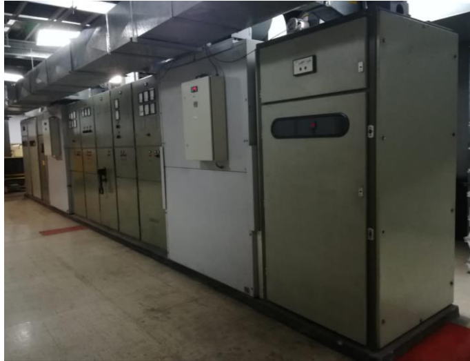
Figura 4. Subestación unitaria ubicada en sótano 3
