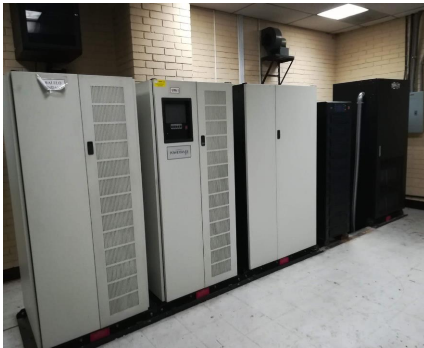
Figura 10. Unidades del sistema de alimentación ininterrumpida
