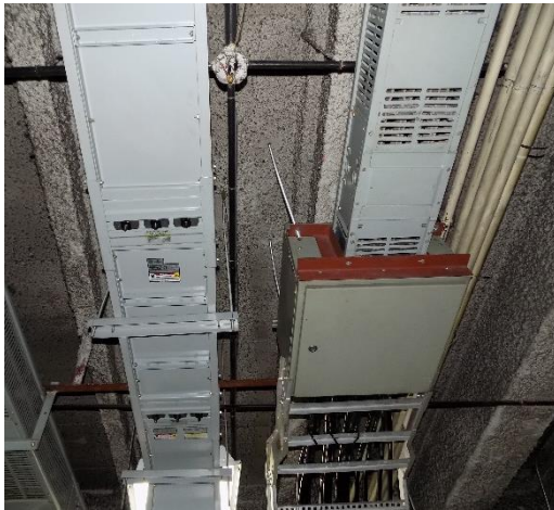
Figura 24. Ductos barra ubicados en la subestación
