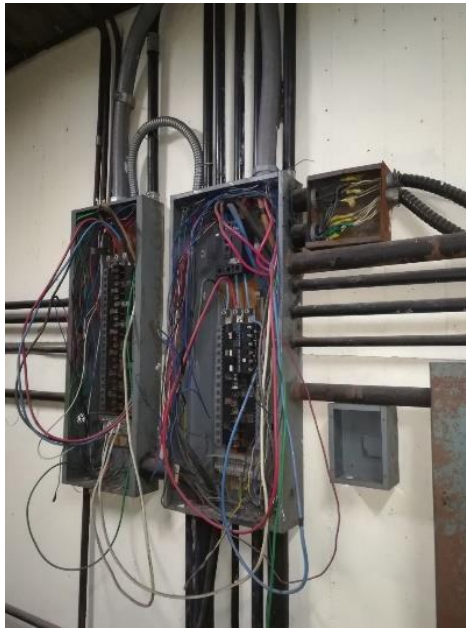
Figura 102. Tableros ubicados en cuarto de estación de bombeo, cisterna, sótano 3, deben revisarse, ordenarse y colocarles las tapaderas
