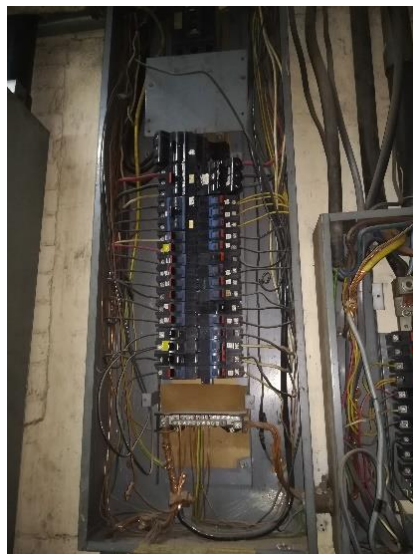
Figura 101. Tableros ubicados en sótanos, deben revisarse, ordenarse y colocarles las tapaderas
