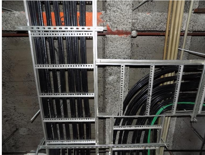
Figura 22. Bandeja porta cable en recinto de subestación sótano 3
