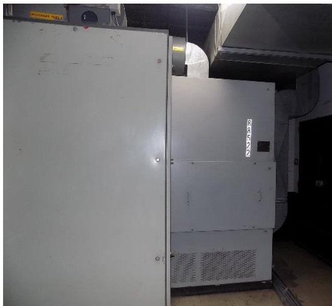
Figura 5. Transformador seco, banco 8852
