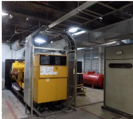
Figura 8. Grupo electrógeno (Planta de Emergencia)
