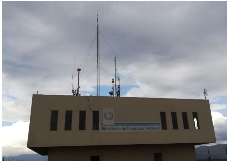
Figura 98. Pararrayos PDC sobre terraza cuarto de máquinas MINFIN
