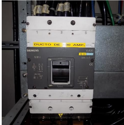
Figura 14. Interrupor tipo MCCB (Norma IEC 60947-2) Molded Case Circuit Breaker , Serie VL 250 marca Siemens, ajustable
