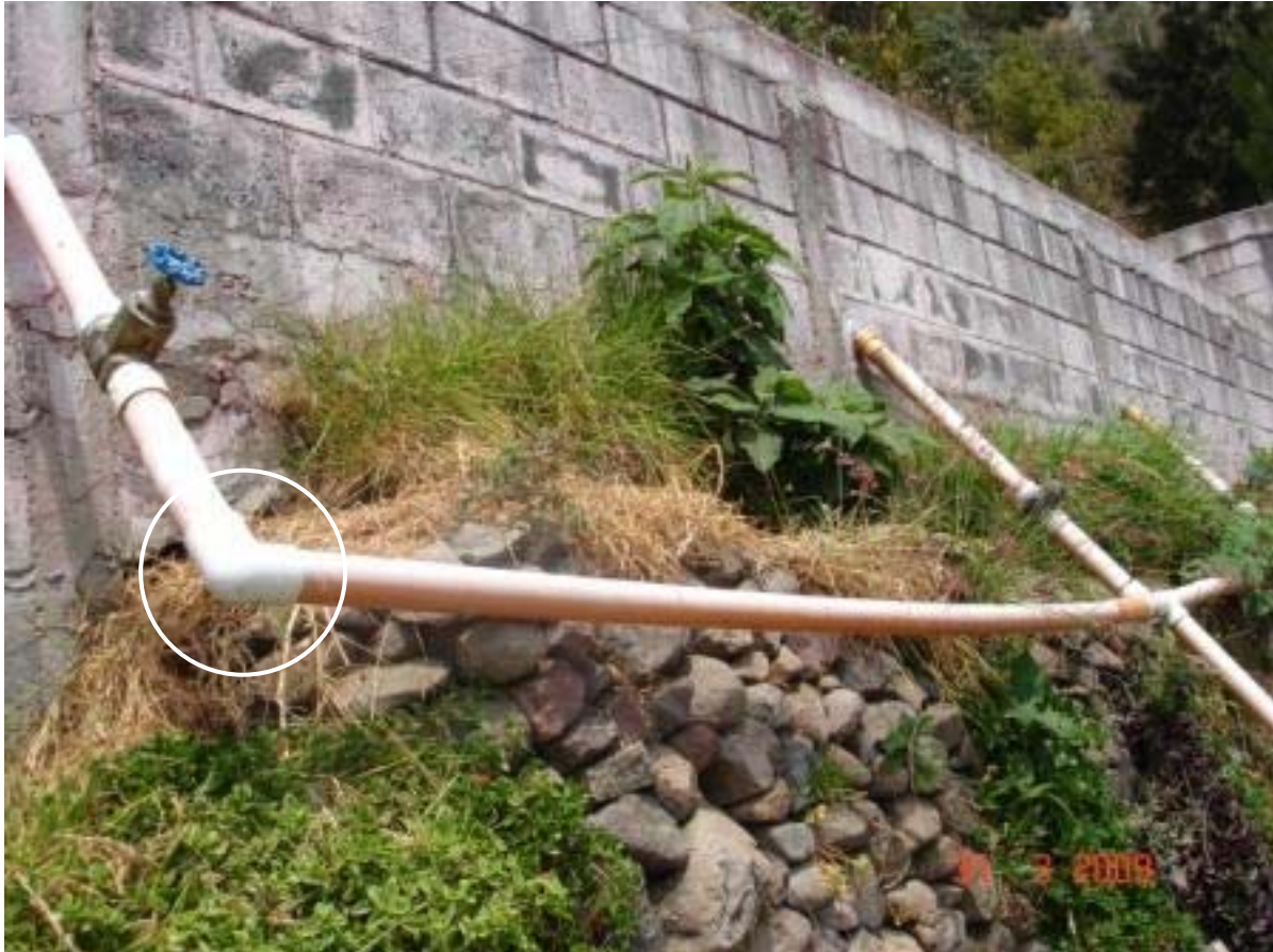
Figura 16. Fotografía Tubería de salida de sedimentadores hacia patio de secado de lodos.
