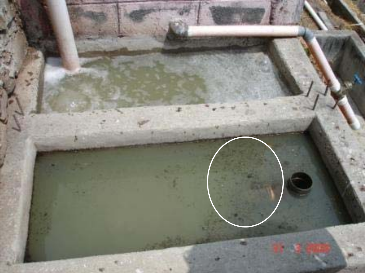
Figura 15. Fotografía Trampa de Grasa
