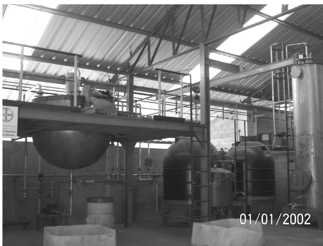
Figura 12. Planta de tratamiento
