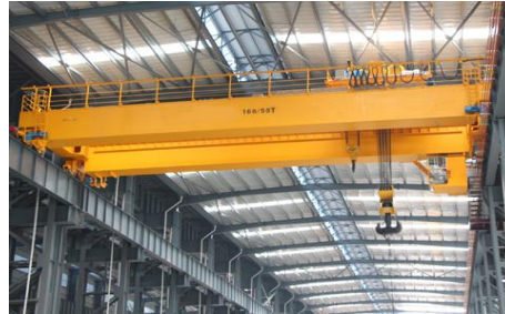
Figura 3. Puente grúa birraíl
