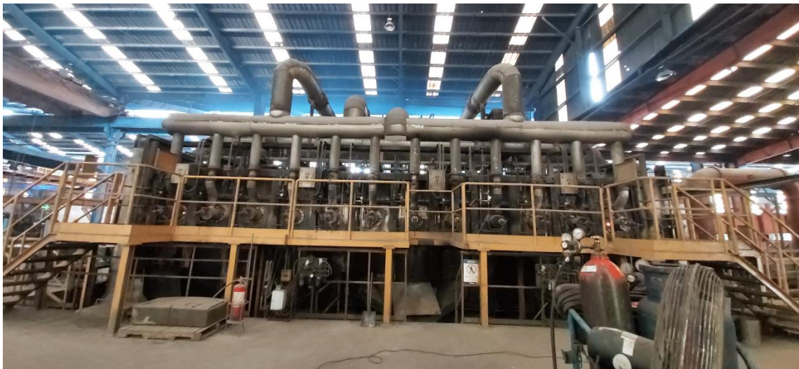
Figura 3. Horno de recalentamiento de palanquillas Bendotti
