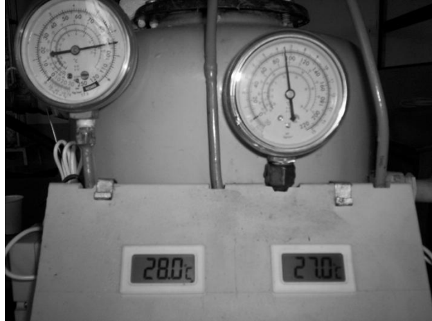
Figura 15. Termómetros en evaporadores
