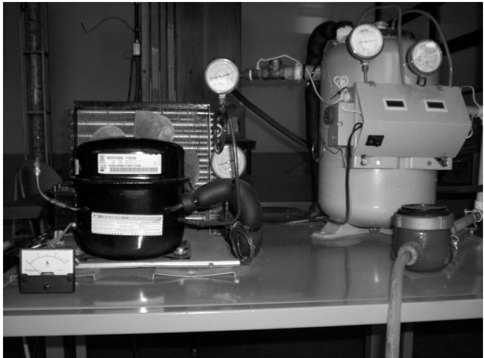
Figura 9. Equipo de refrigeración por compresión de gas R134a
