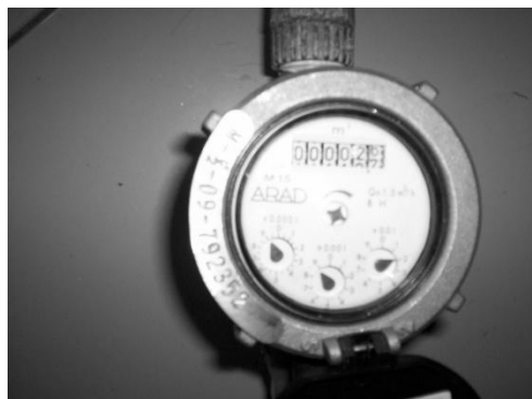
Figura 32. Medidor de flujo
