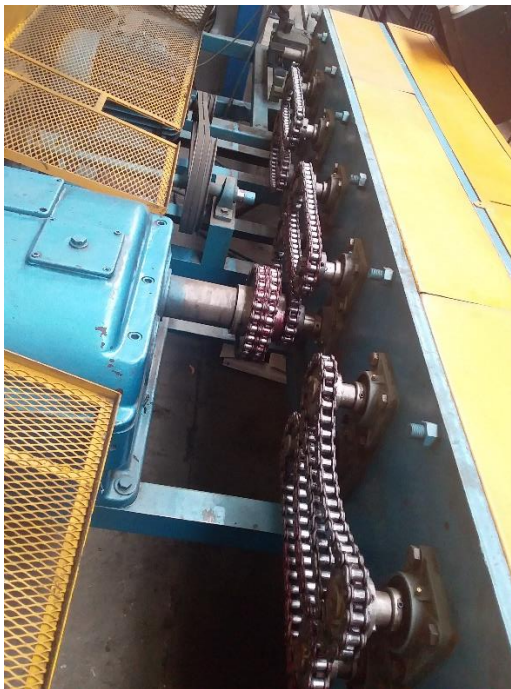
Figura 8. Motor y sistema de transmisión
