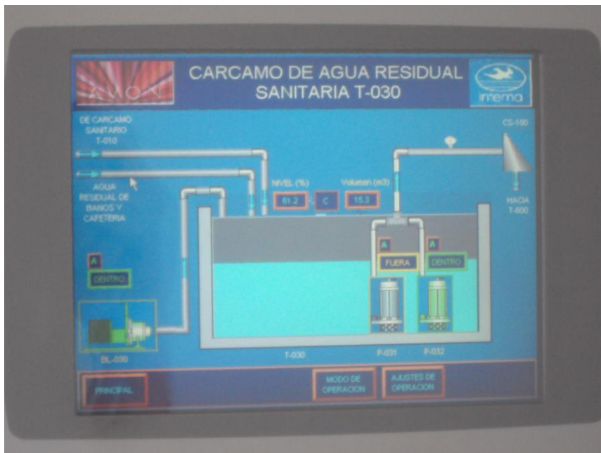
Figura 17. Fotografía 4. Panel de control electrónico del sistema de la PTAR
