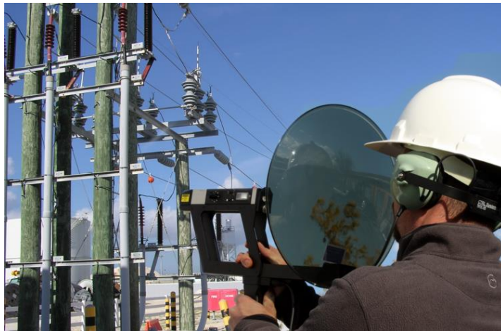
Figura 21. Inspección ultrasónica en subestación
