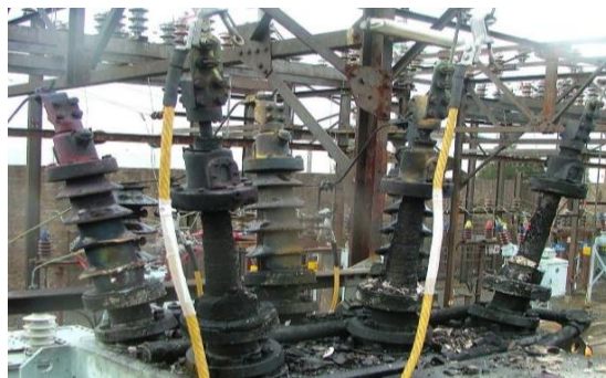
Figura 12. Falla en interruptor de potencia
