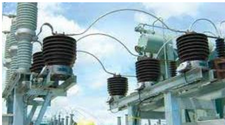
Figura 6. Transformadores de instrumento tipo subestación
