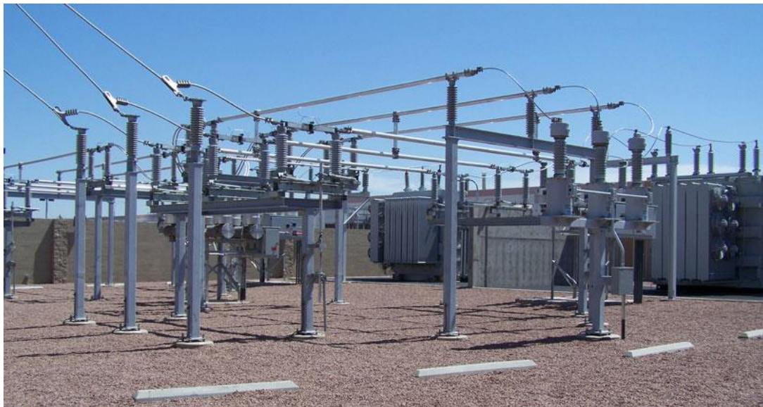
Figura 4. Equipos de subestación eléctrica en patio
