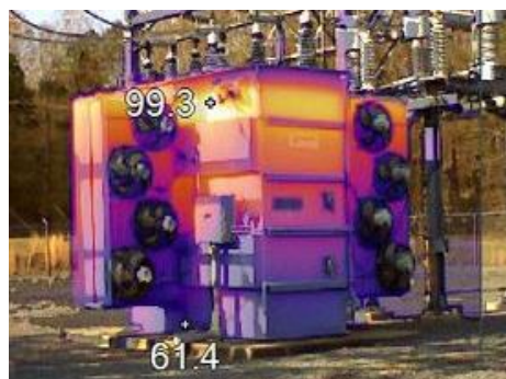
Figura 10. Termografía aplicada a un transformador de subestación
