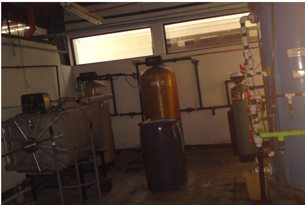
Figura 2. Columnas de tratamiento de agua en planta de fabricación de cosméticos
