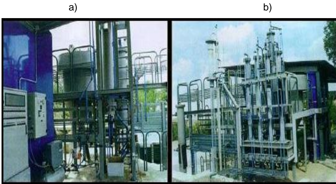
Figura 14. Tratamientos terciarios a) ozonización y b) filtro de carbón activado
