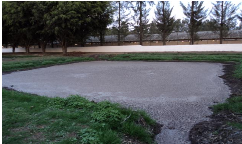
Figura 42. Colocación de revestimiento de concreto en los taludes de la cuarta laguna
