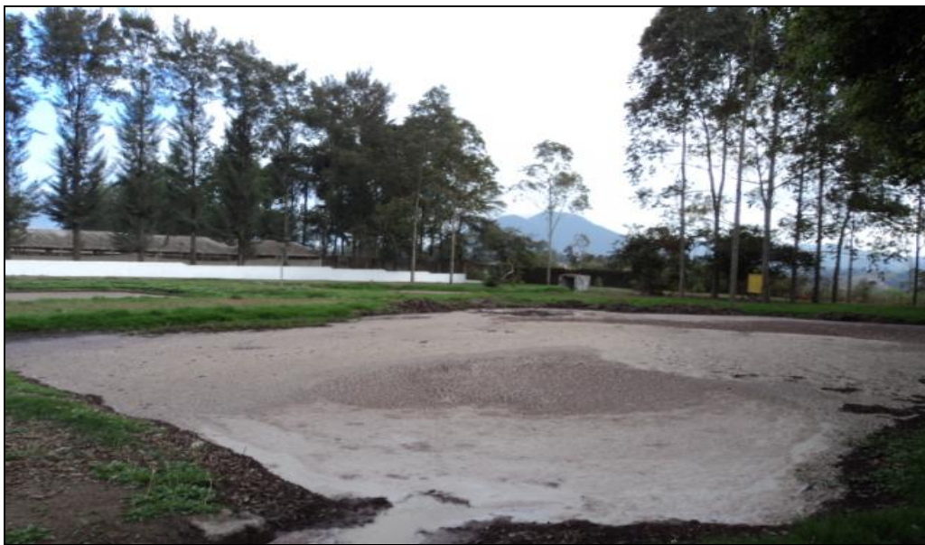
Figura 46. Laguna de estabilización con un nivel de agua, no apropiada
