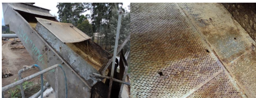
Figura 20. Tamizador en mal estado
