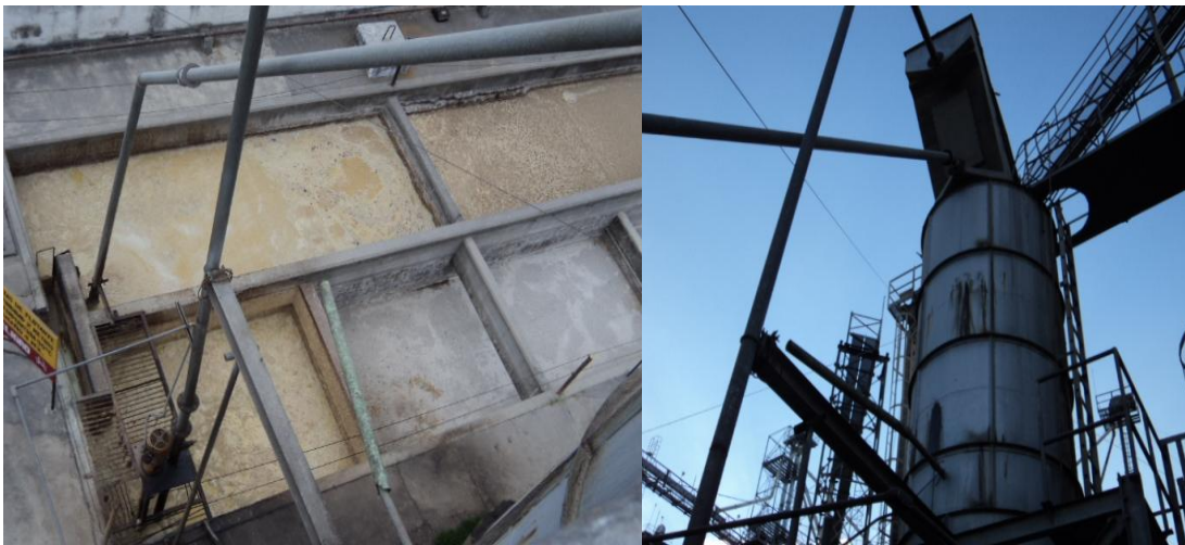
Figura 15. Separación de los sólidos gruesos del agua residual
