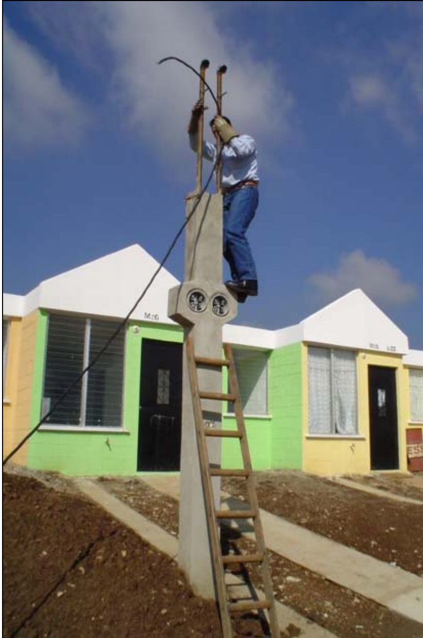
Figura 25. Vista de la conexión de un servicio nuevo, del poste de la acometida eléctrica
