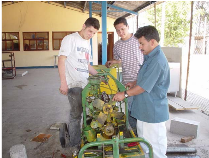
Figura 11. Fotografía de mantenimiento de generador de energía eléctrica
