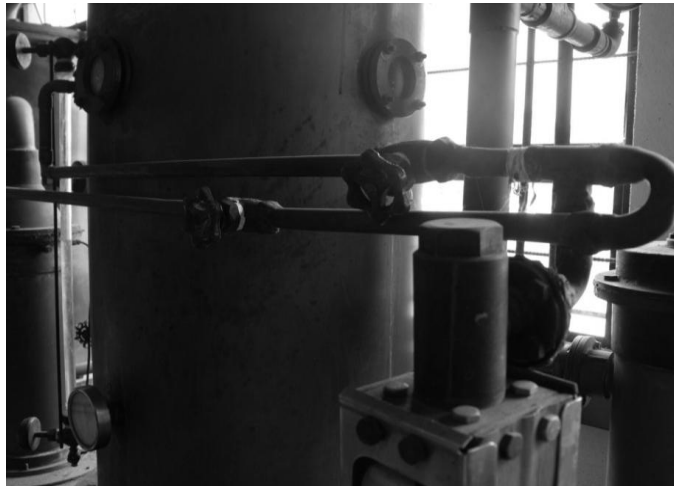
Figura 25. Válvulas de la alimentación de agua (V-118a y V-118b)
