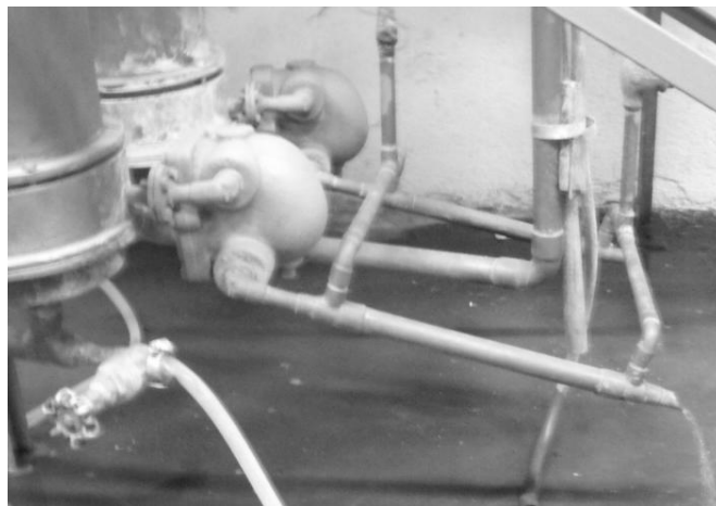
Figura 15. Trampas de vapor e Intercambiadores de calor de tubos concéntricos
