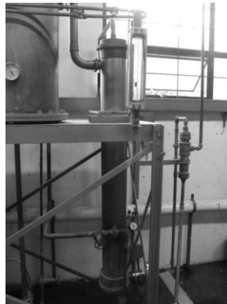
Condensador de superficie
