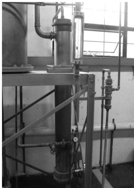
Figura 17. Condensador de superficie
