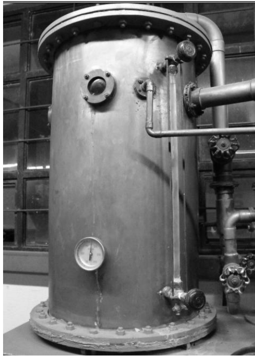
Figura 13. Separador del evaporador
