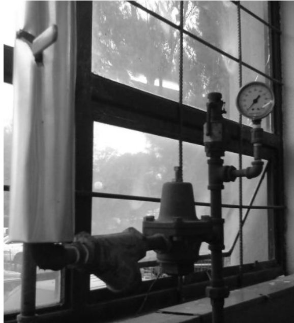
Figura 20. Tubería de alimentación de vapor
