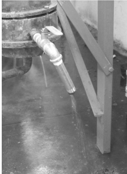
Figura 27. Válvula de compuerta V-114b
