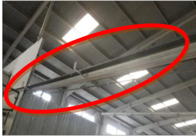
Figura 31. Tubería de vapor sin aislamiento en cuarto de lavado
