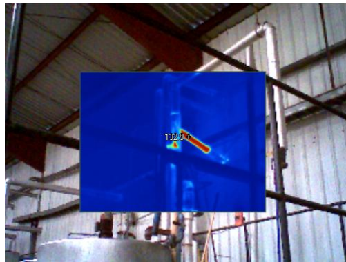
Figura 33. Tubería no aislada
