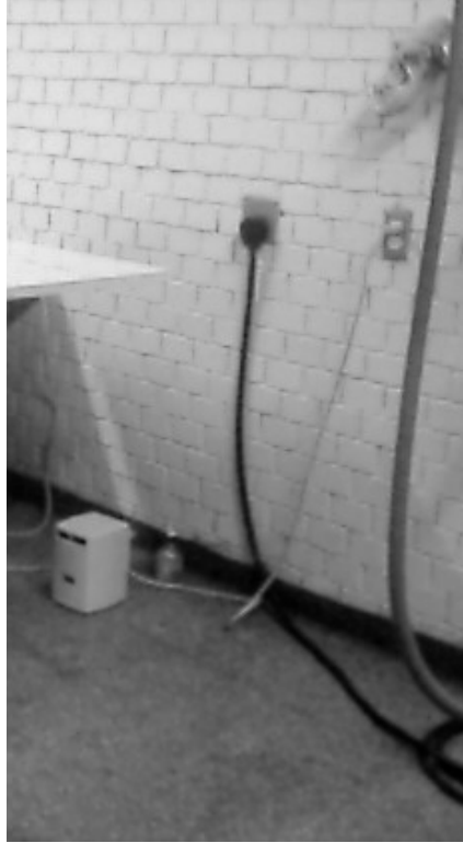
Figura 12. Instalaciones eléctricas en el comedor
