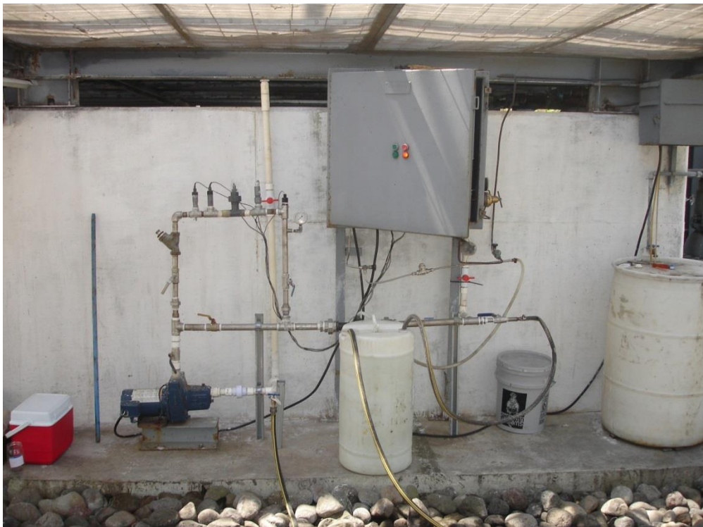
Figura 1. Equipo utilizado para calcular la velocidad de reacción del gas ozono con cianuro en aguas residuales del proceso MacArthur-Forrest
