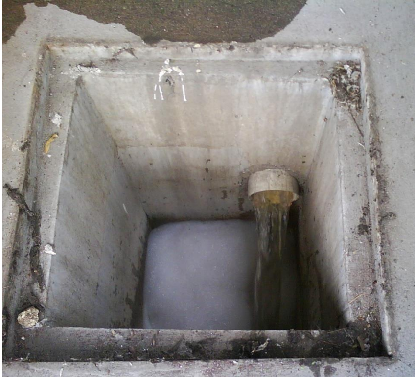
Figura 6. Efluente final que va al alcantarillado, combinado de todas las pilas por rebalse
