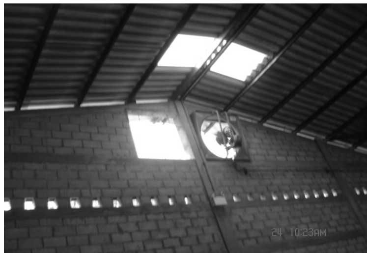
Figura 6. Iluminación y ventilación actual
