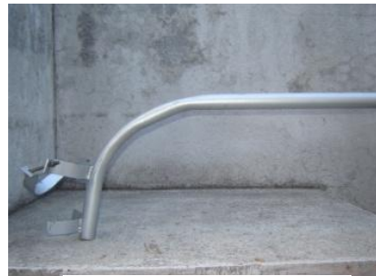
Soporte de Luminaria
