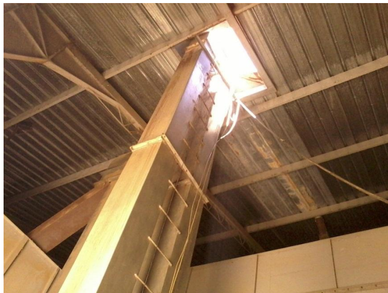
Figura 20. Torre de llenado
