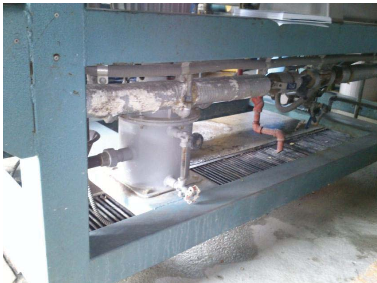
Figura 3. Ubicación de la caldera y área para la descarga del condensado
