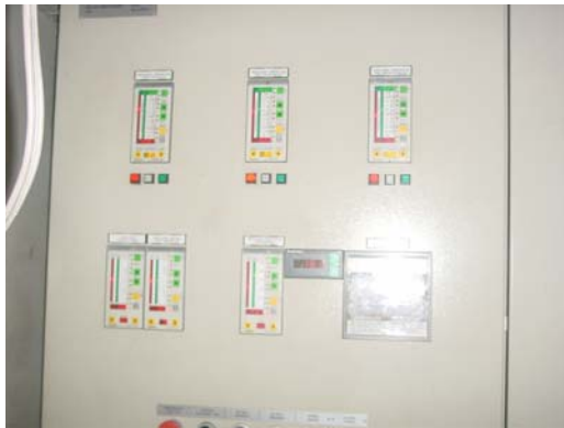
Figura 19. Panel de control de las temperaturas del horno
