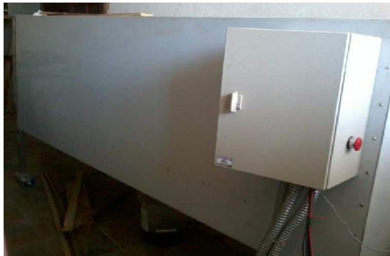
Figura 5. Cámara de vapor
