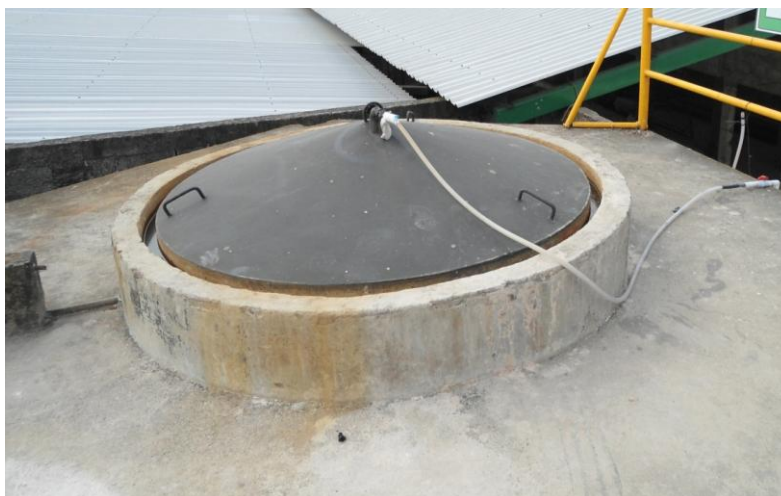
Figura 12. Parte superior del biodigestor
