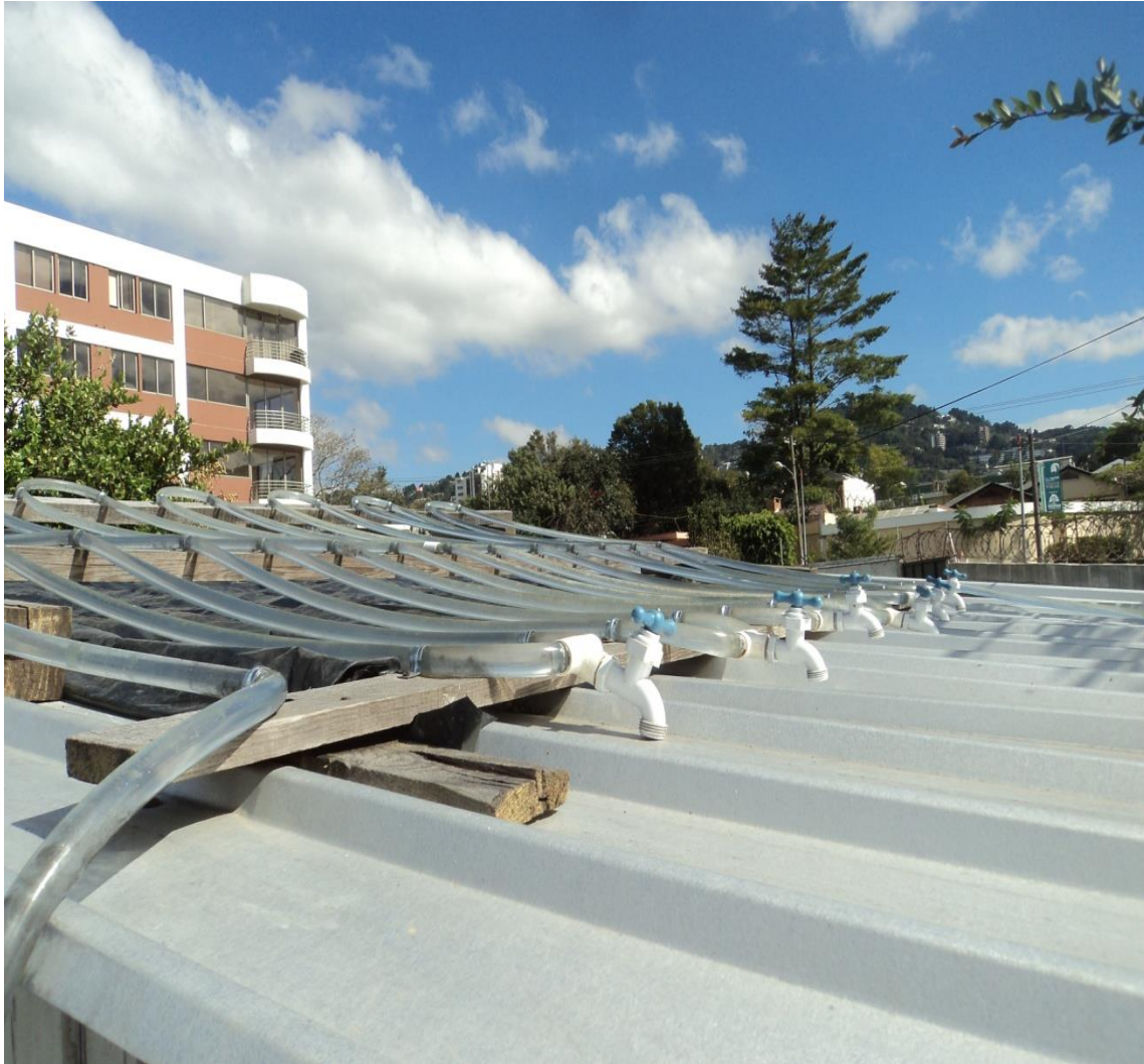
Figura 17. Válvulas para eliminar agua remanente del sistema de desinfección solar al terminar el ciclo de desinfección
