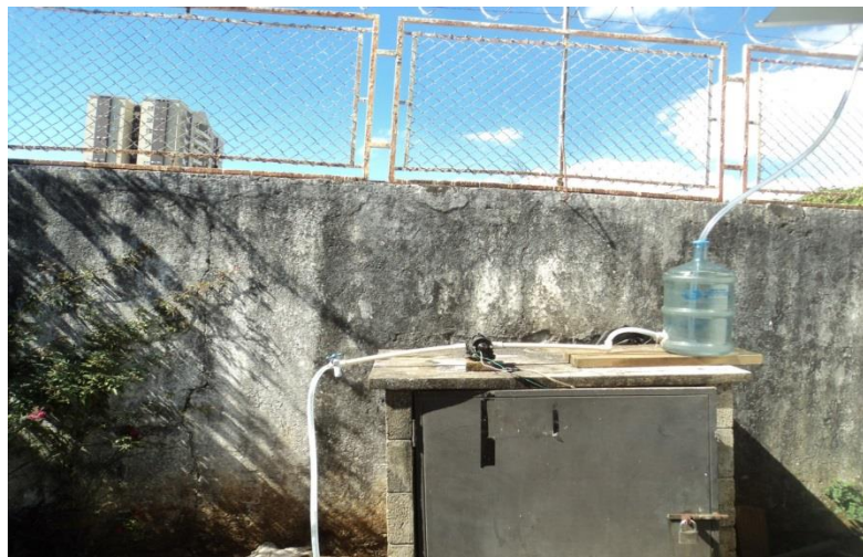
Figura 16. Sistema de desinfección solar de agua con recirculación continua construido
