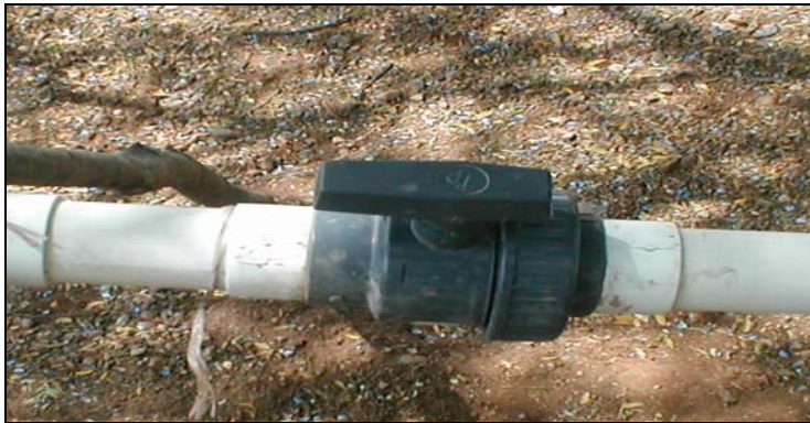
Figura 23. Válvula del filtro principal
