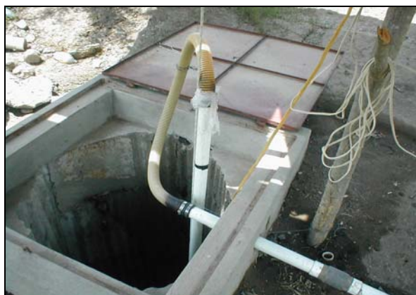
Figura 24. Bomba sumergible de 1 HP. Pozo artesanal.
