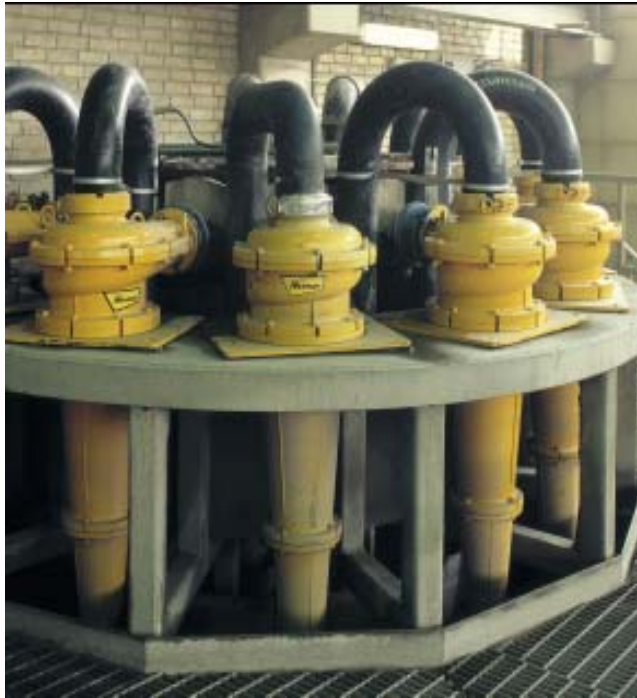
Figura 33. Hidrociclones instalados en forma circular
