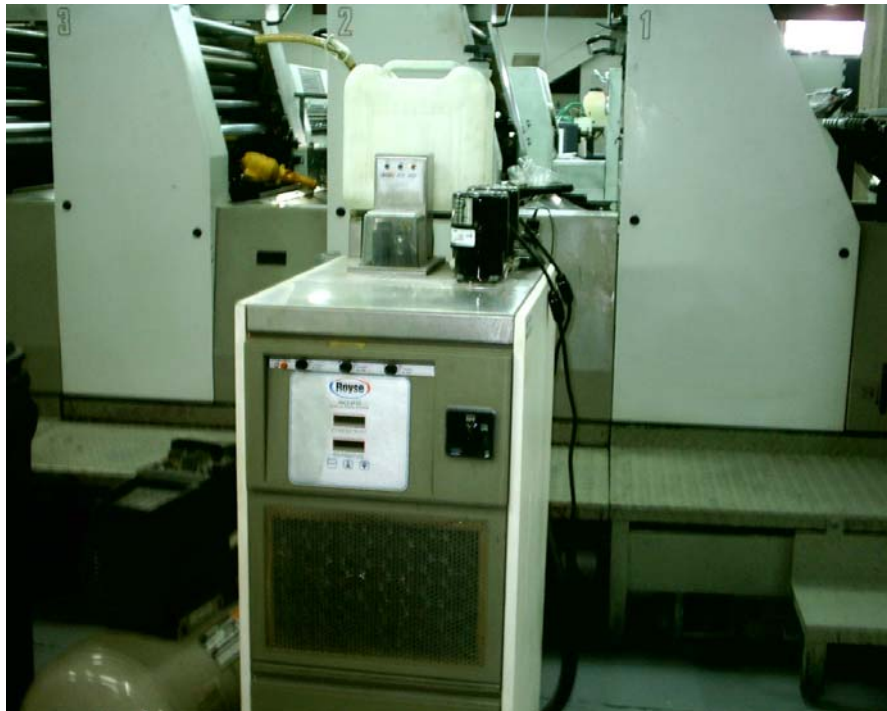
Figura 18. Equipo de enfriamiento y control del isopropanol
