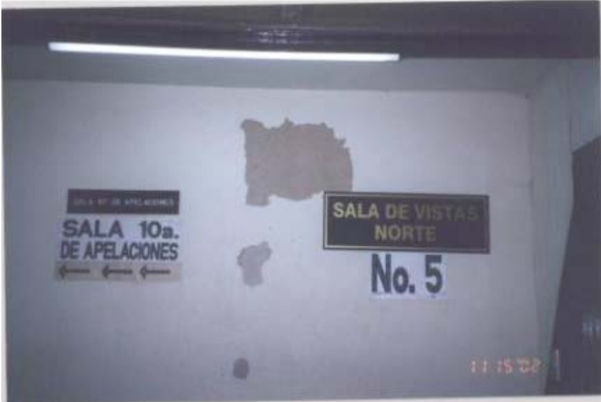
Figura 30. Paredes interiores defectuosas.
