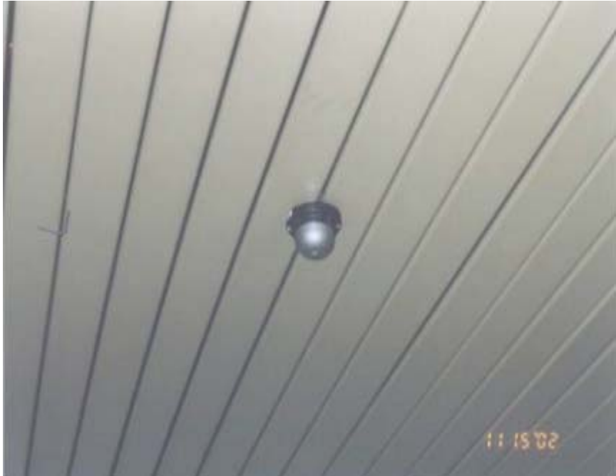
Figura 31. Detectores de humo sin funcionar.
