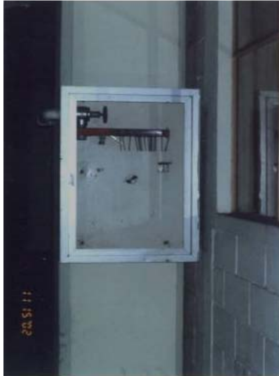
Figura 24. Inexistencia de equipo contra incendios.
