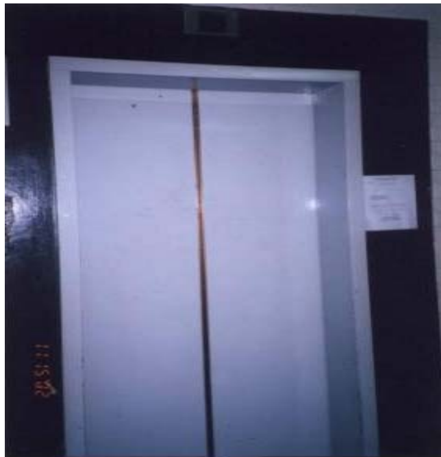
Figura 17. Ascensores de la Corte Suprema de Justicia descontinuados
