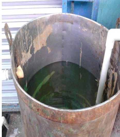
Figura 23. Tanque de sedimentación
