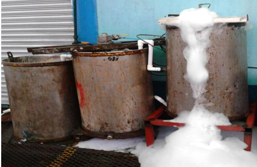
Figura 25. Tanques de aireación, coagulación-floculación, sedimentación
