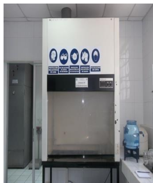
Figura 13. Campana de extracción de gases
