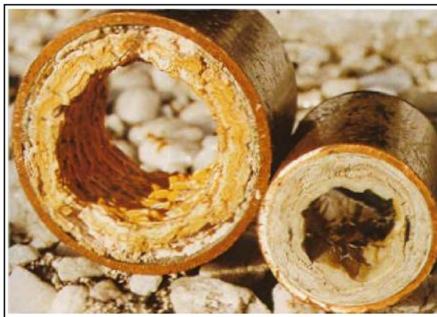
Figura 11. Precipitaciones en tuberías
