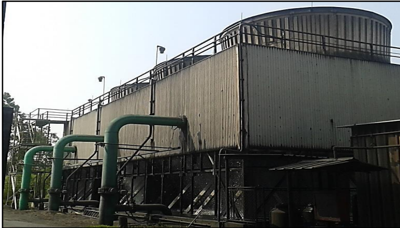
Figura 5. Torre de circulación mecánica (tiro inducido)
